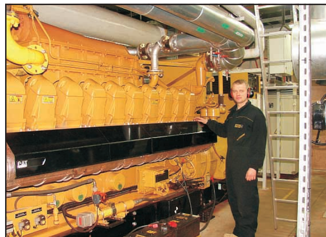
Maszynownia układu kogeneracji w oparciu o silniki gazowe Caterpillar - Michał Gubarew, inżynier serwisu firmy Eneria.
