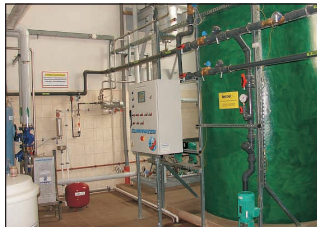
Stacja przygotowania wody kotłowej.
